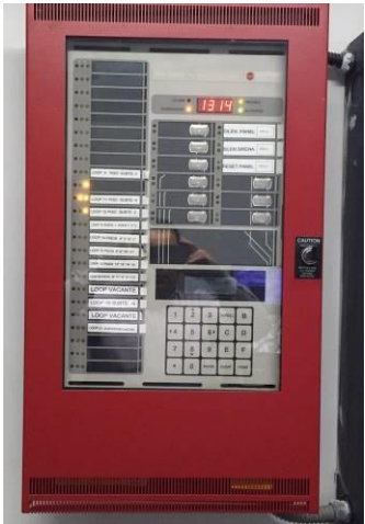
Central Alarmas Incendio Sala de Control -2°
